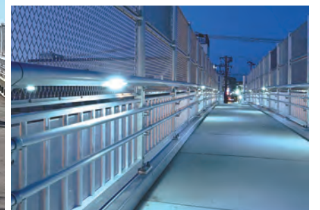
落下物防止柵・裾隠し板 照明内蔵高欄・補助手すり
