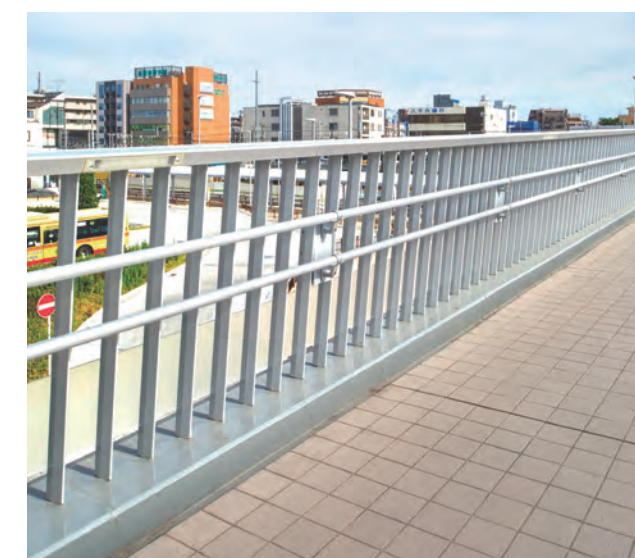
長津田駅北口歩行者専用通路 / 神奈川県 種別: SP種 タイプ: アルミ合金製+LED照明内蔵 工事: 新設
