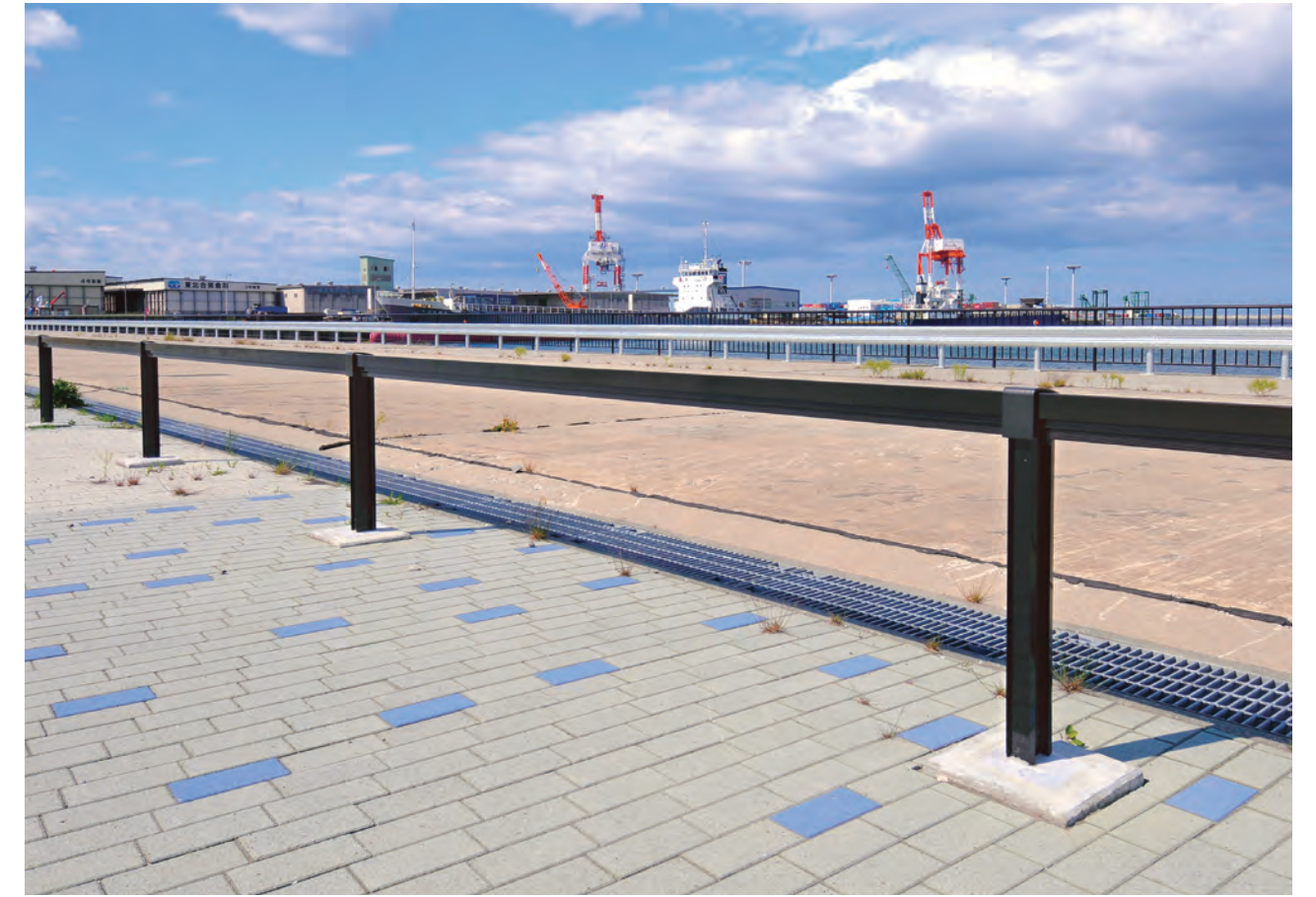
八太郎緑地 横断防止柵/青森県 種別:P種 タイプ:アルミ合金製標準 工事:新設
