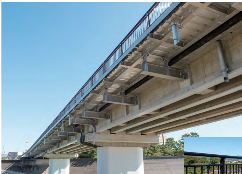
新志原橋拡幅／三重県 アルミ歩道拡幅床版(PC橋ブラケット方式)・ 高欄:アルミ合金製SP種
