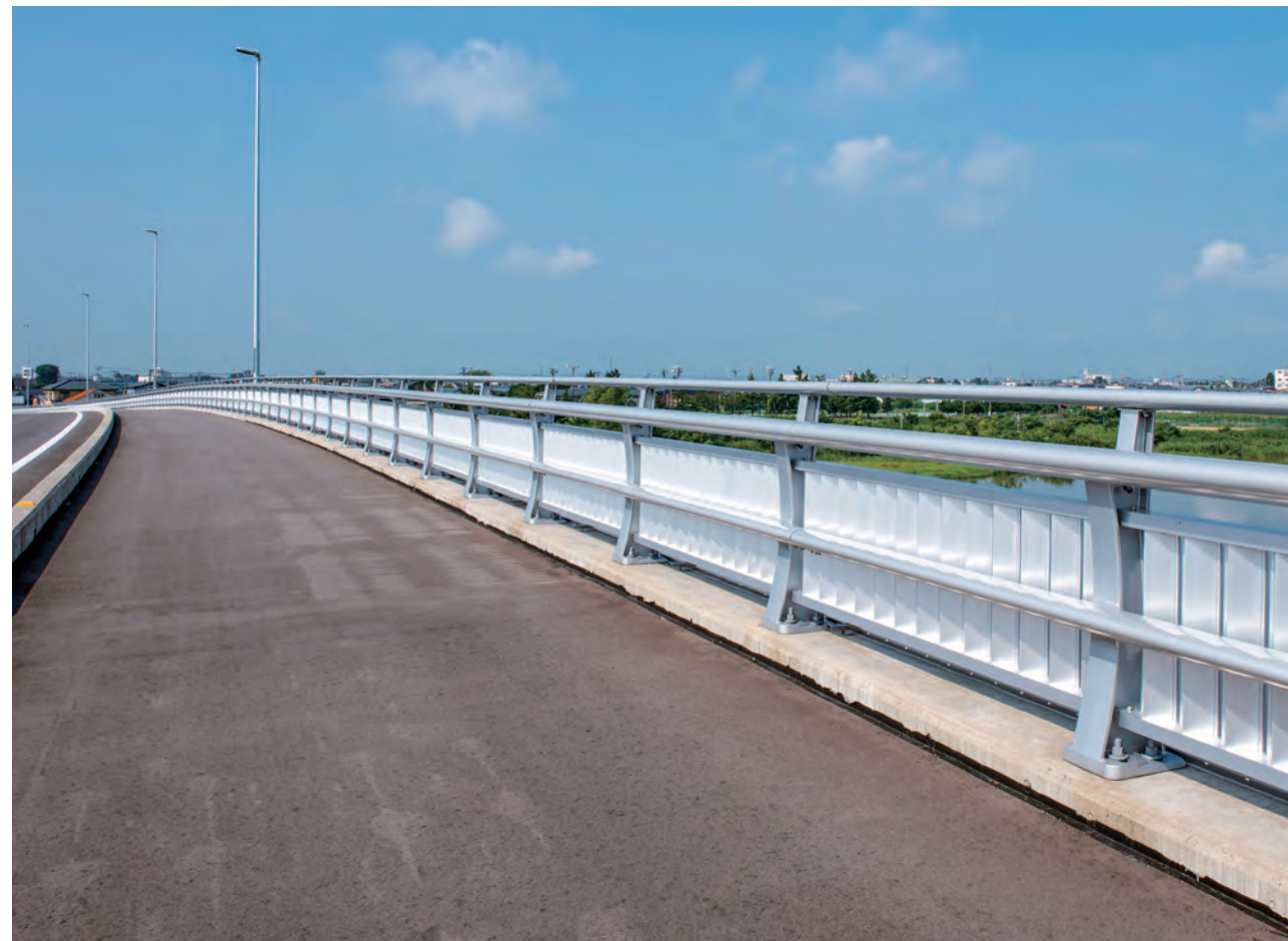
朝日大橋／新潟県 種別:A種 タイプ:キャブロー 工事:新設
