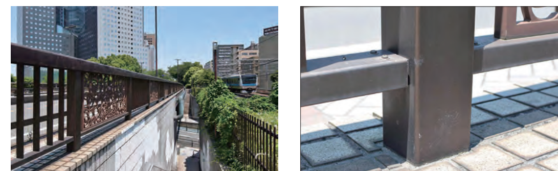
その他:飛来鉄粉の付着が想定される場所 堀川町跨道橋／神奈川県 平成元年設置→令和3年撮影(32年経過)
