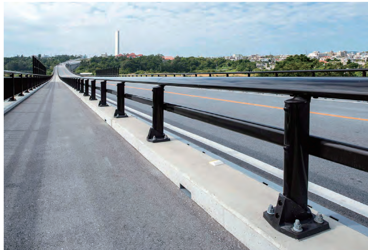
金武BP2号橋／沖縄県 種別: A種・Ap種・SP種 タイプ: アスレール 工事: 新設
