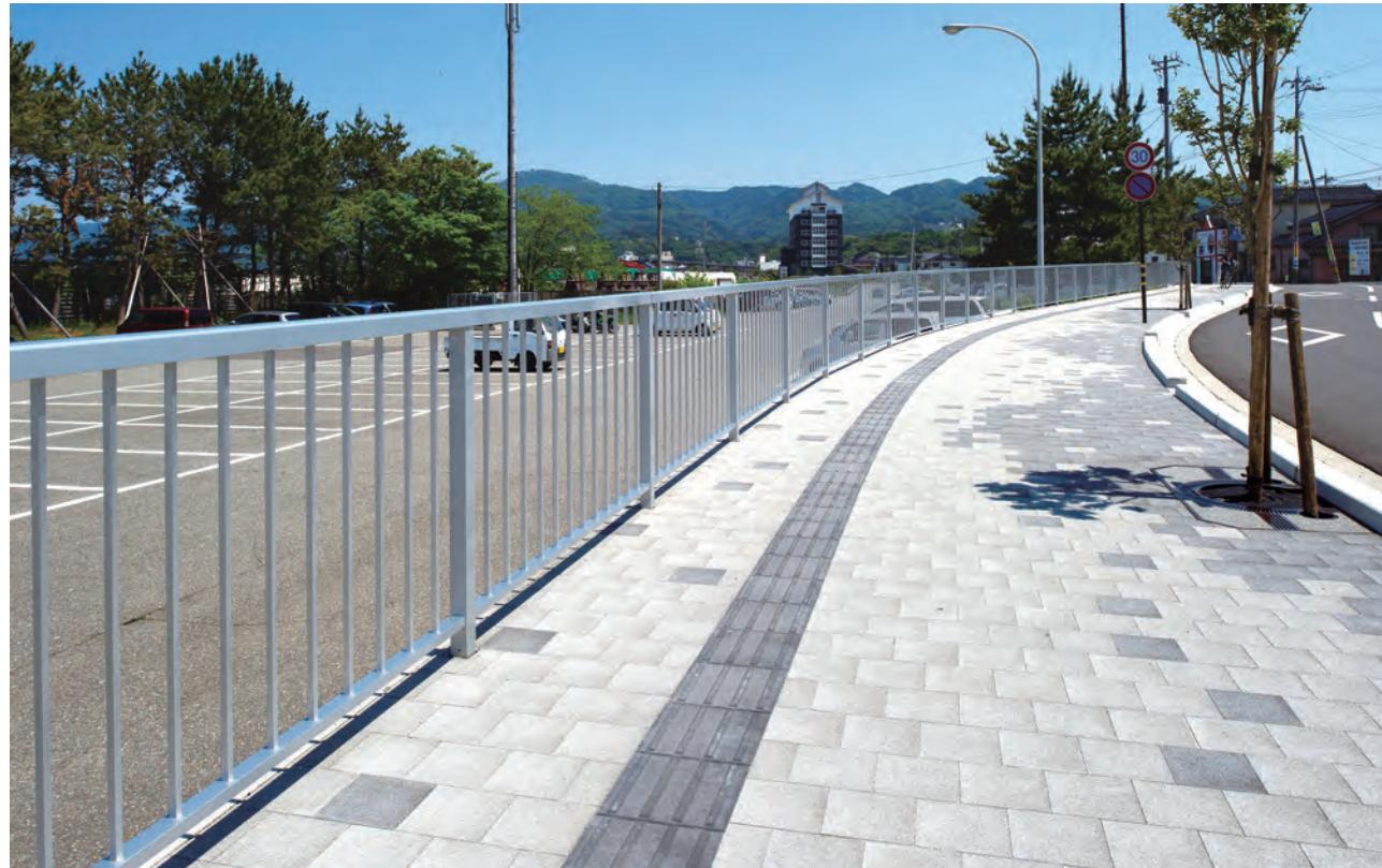
輪島市道みなと線 転落防止柵/石川県 種別:P種 タイプ:アルミ合金製標準 工事:新設
