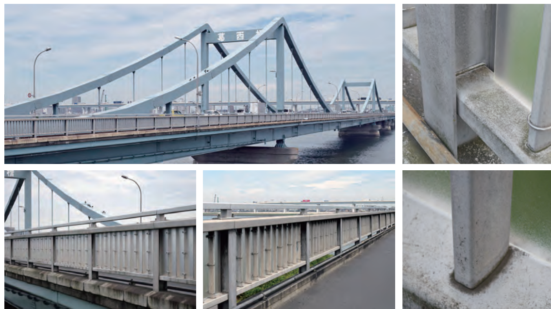
施工後50年以上 葛西橋／東京都 昭和38年設置→令和3年撮影(58年経過)
