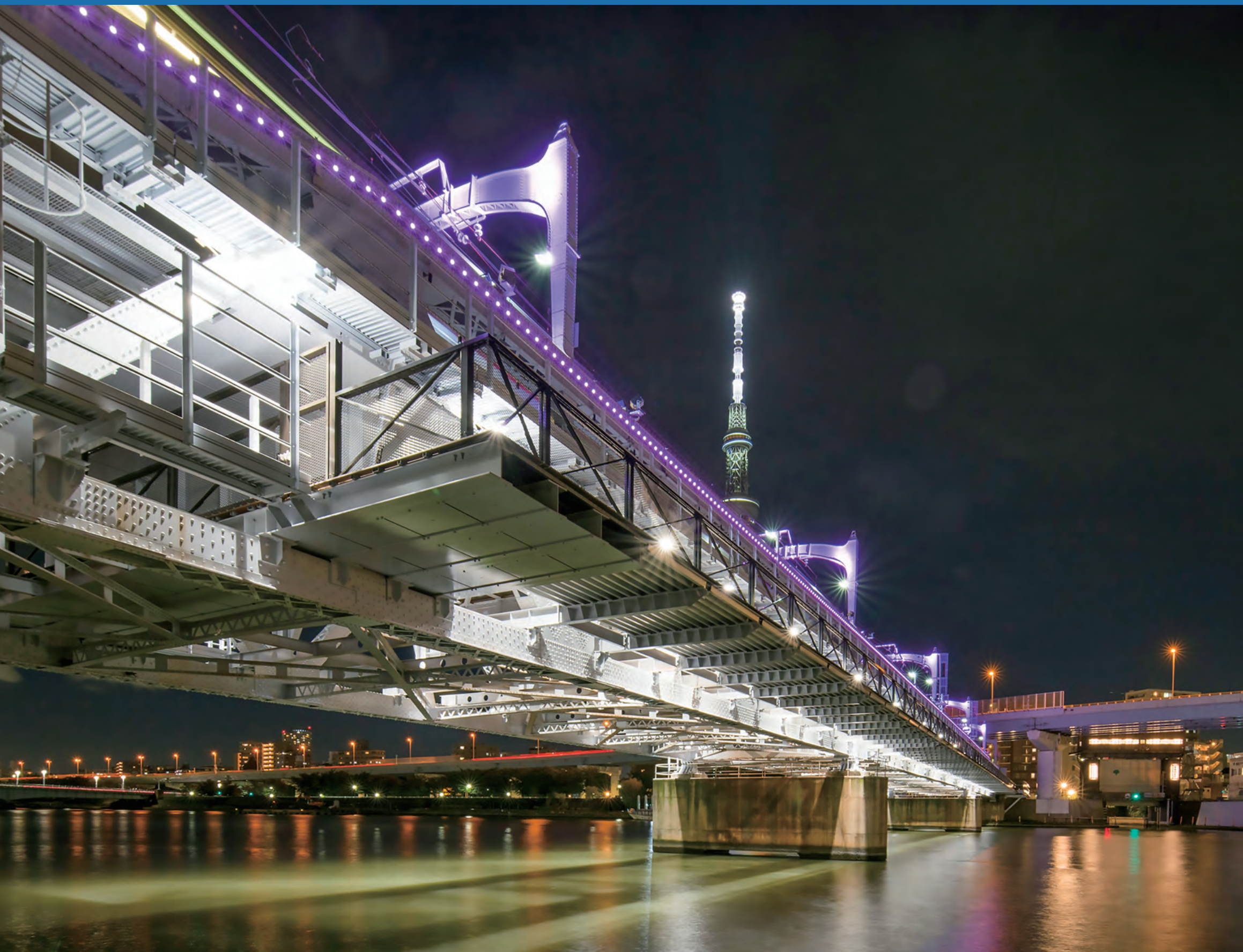
すみだリバーウォーク/東京都 (アルミ歩道拡幅床版・アルミ製転落防止柵・検査路)
