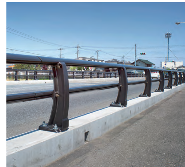
新波橋/群馬県 種別: Cp種 タイプ: キャブローア 工事: 改修
