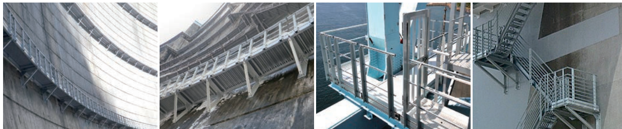
管理路歩廊 管理路歩廊/管理扉 点検路階段/後付け施工
