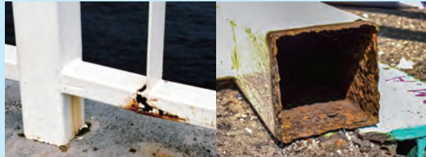
キズからの腐食の進行 腐食リスクが高い部材内部
