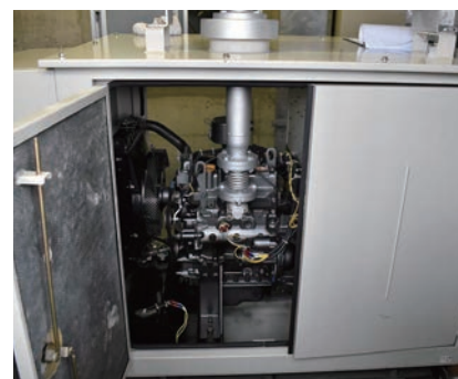
d.電気設備・発電設備
