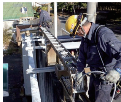
ケーブルベア/ケーブル交換
