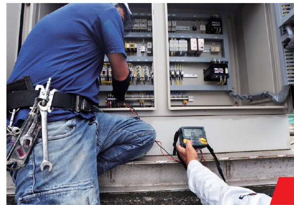
▲電動装置操作盤の通電確認
