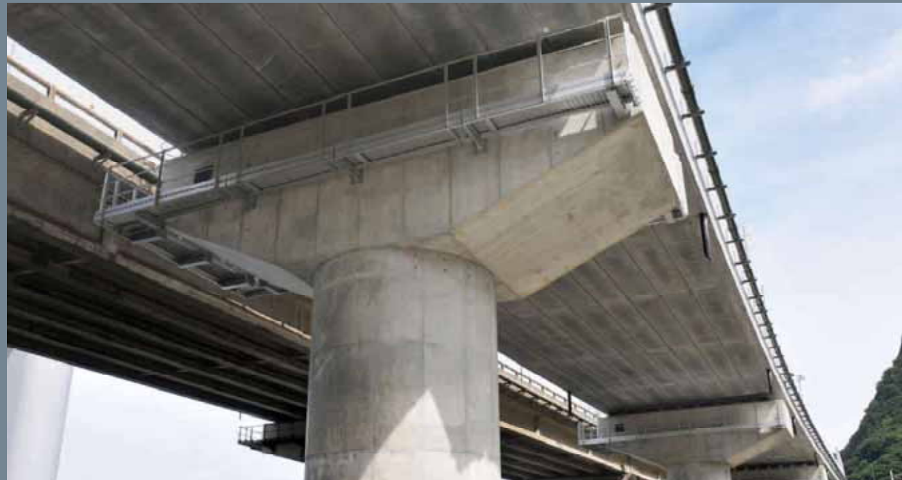
件名：歌高架橋 施主：国土交通省北陸地方整備局高田河川国道事務所 場所：新潟県糸魚川市
