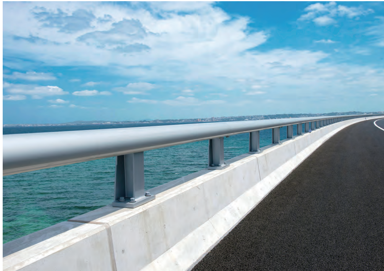
浦添北道路(港川高架橋)／沖縄県 種別: SB種 タイプ: アルミ合金製標準 工事: 新設
