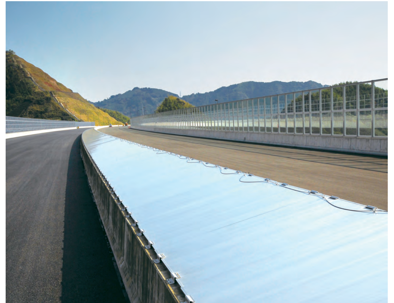
第二東名高速道路／静岡県 種別:閉塞板 タイプ:アルミ合金製 工事:新設
