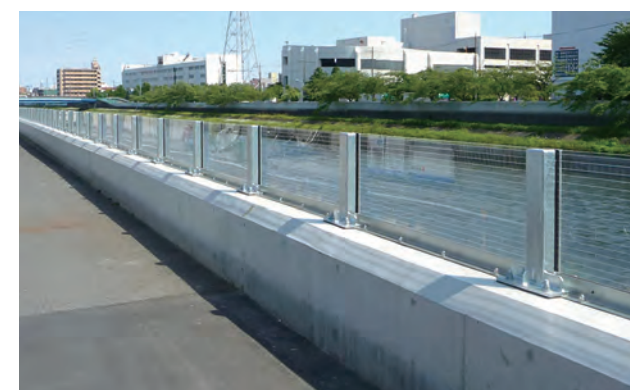
新河岸川嵩上げ／東京都 種別:アクリル止水壁 工事:新設
