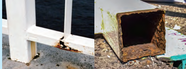
キズからの腐食の進行
