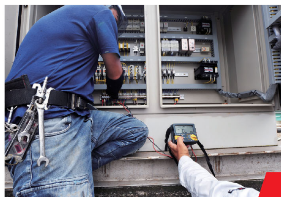
▲電動装置操作盤の通電確認
