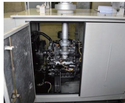
d. 電気設備・発電設備
