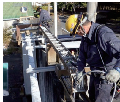
ケーブルベア／ケーブル交換
